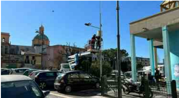
Napoli Est, arriva la videosorveglianza: lavori a Barra dopo i danni all'impianto
